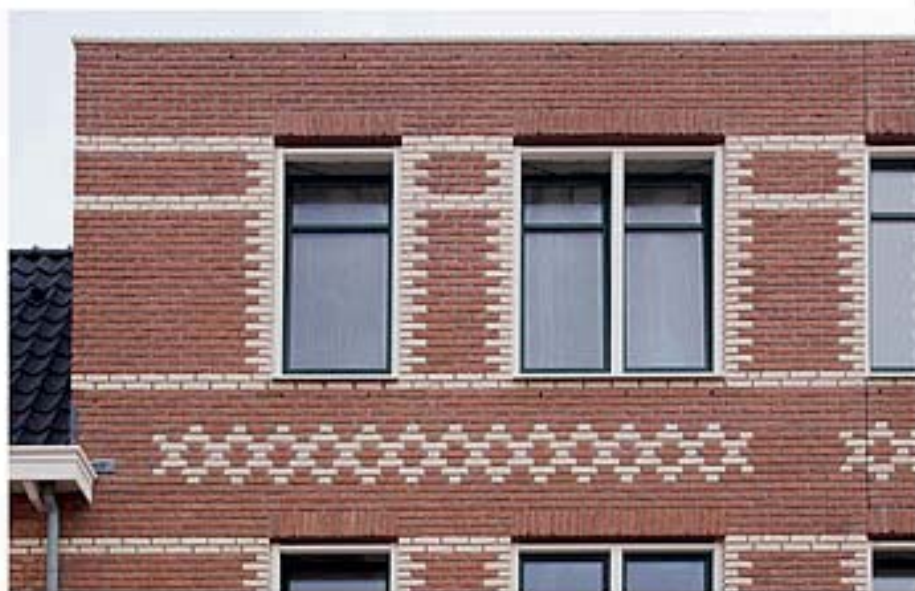
Van een afstand vallen de aanpassingen niet op; wat bereikt is, is een strak en regelmatig gevelaanzicht. Let nog even op de dilatatie dwars door het kruiswerk rechts
